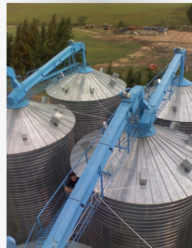
Transportadores sobre silos.
